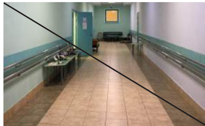
Плохо Керамогранитная плитка с крупными швами
